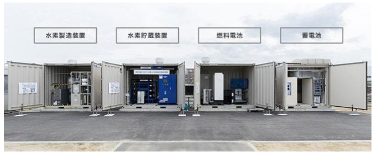
水素エネルギー利用システム導入事例 (清水建設 Hydro Q-BiC)
