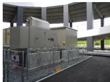
非常用発電機システム
