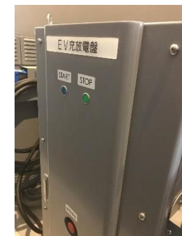
EV充放電器盤
