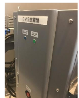
EV充放電器盤
