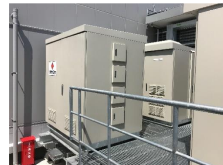
(左) リュース蓄電池盤 (右) PCS盤
