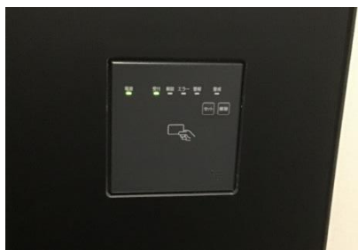
非接触ICカードリーダー (貸室扉)
