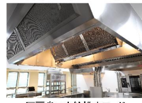
厨房省エネ給排水フード +ファンINV+CAV制御
