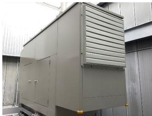
非常用発電機
