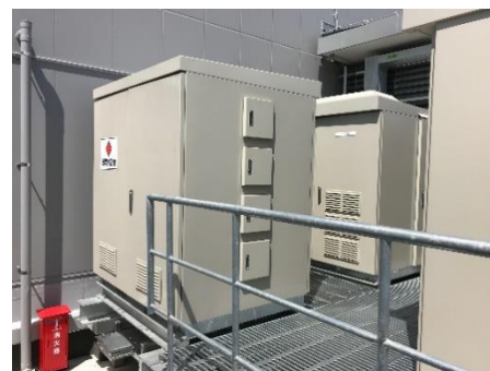
(左) リユース蓄電池盤 (右) PCS盤
