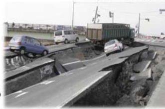
車両も巻き込んだ地割れ
