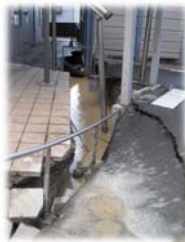
陥没した病院構内
