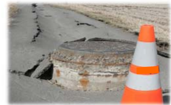
浮き上がったマンホール
